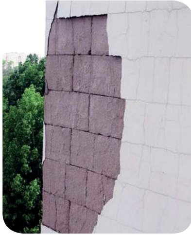
Рис. 8.1. Пошкодження штукатурки на фасаді будинку
