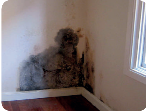
Рис. 7.11. Грибок на оштукатуреній поверхні
