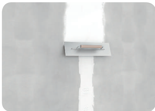
Рис. 7.20. Нанесення шпаклювальної маси на стики плит
