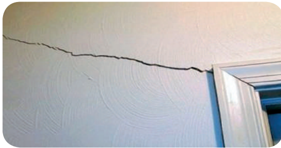
Рис. 7.14. Тріщини на оштукатуреній поверхні
